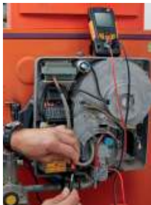
Măsurări pentru reglarea curentului de ionizare
