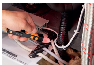
Verificare preliminară pe un compresor
