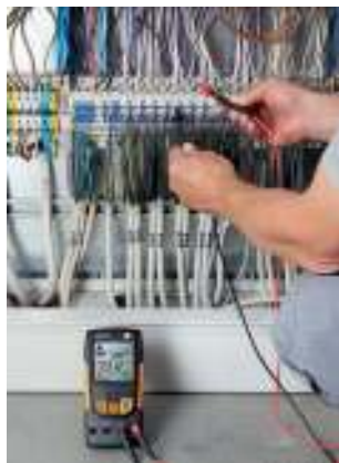
Testarea tensiunii într-un tablou electric.
