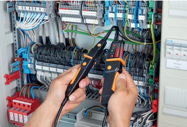
Măsurarea tensiunii într-un tablou electric.
