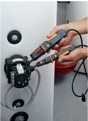
Măsurarea tensiunii la un boiler.
