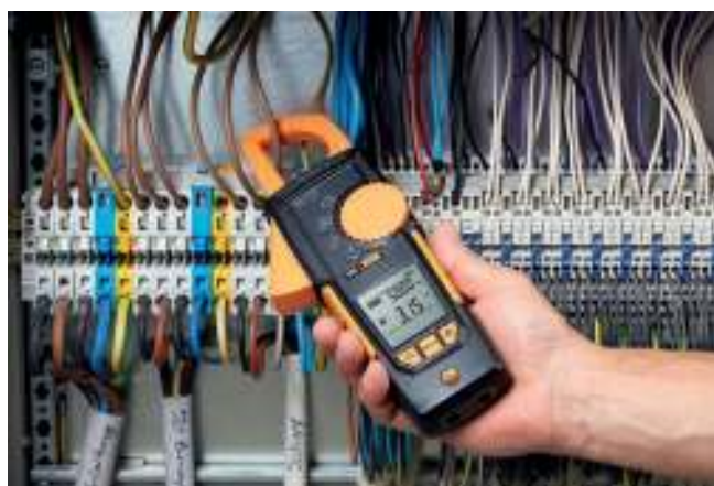
Măsurarea curentului într-un tablou electric.
