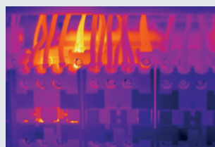
Mentținerea sistemelor: identificarea temperaturilor înalte în întrerupătoare de circuit și a componentelor electrice pentru prevenirea defecțiunilor.
