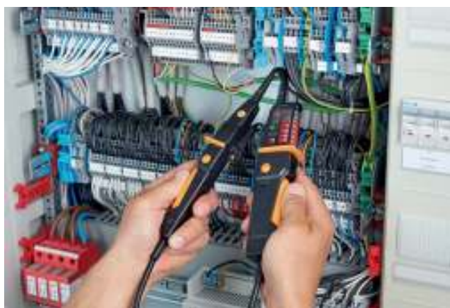
Măsurarea tensiunii într-un tablou electric.
