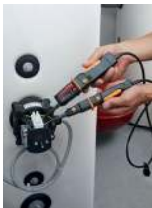
Măsurarea tensiunii la un boiler.
