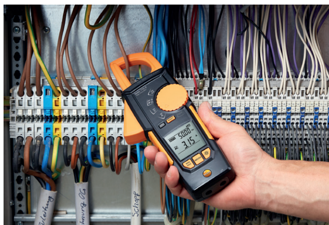
Măsurarea curentului într-un tablou electric.
